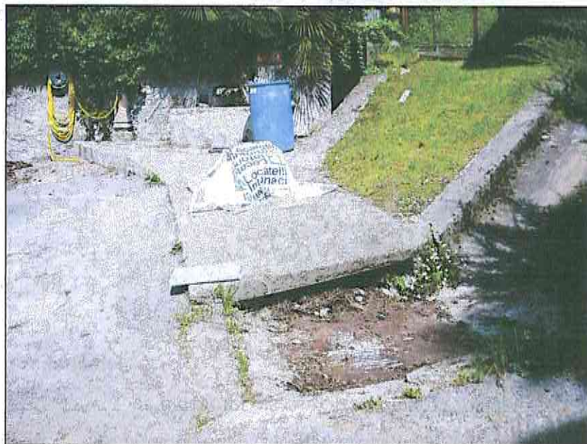
FIG. 3 Tratto corso d'acqua CC tombato
